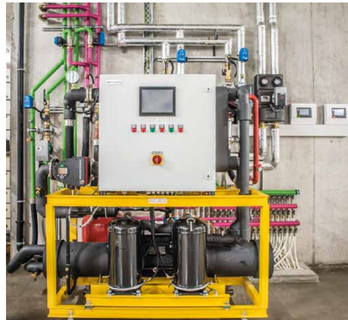
Wärmepumpe gespeist von Solarthermie: vorne 2 x 9 kW Verdichter, hinten NT-Wärmetauscher, rechts oben HT Wärmetauscher, links oben Soleanschluss (Wärmequelle) Naturkosmetik Metzler, Egg
