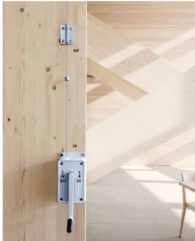
Landwirtschaftliches Zentrum SG in Salez Kurbel Mechanismus Lüftungsschacht
